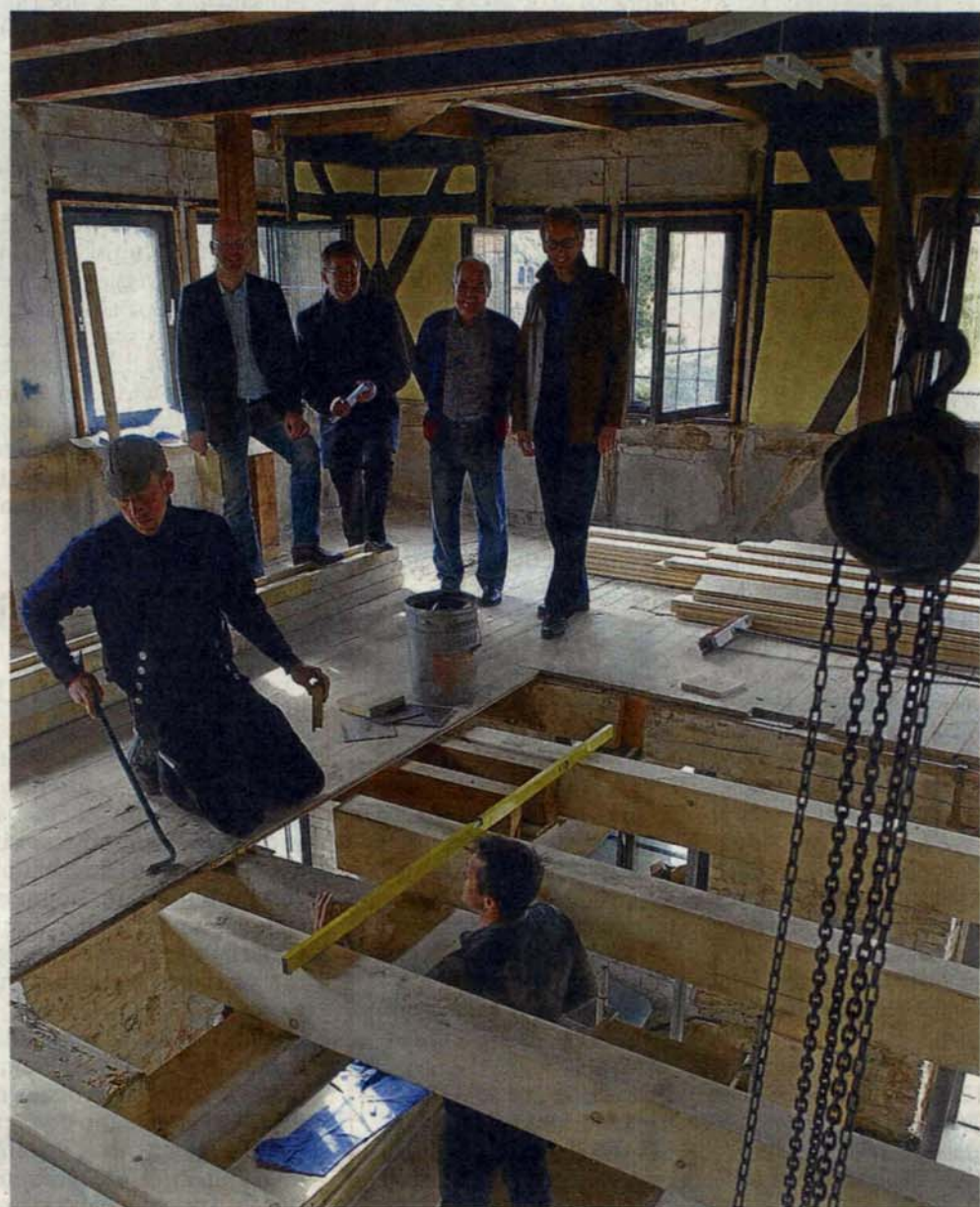
Die Arbeiten in der Schlossmühle gehen voran. Mittlerweile ist das Gebäude komplett entkernt. Am 1. April werden private Bauherren dort von Experten über Möglichkeiten informiert, wie sie ihre Immobilien sanieren und modernisieren können.
