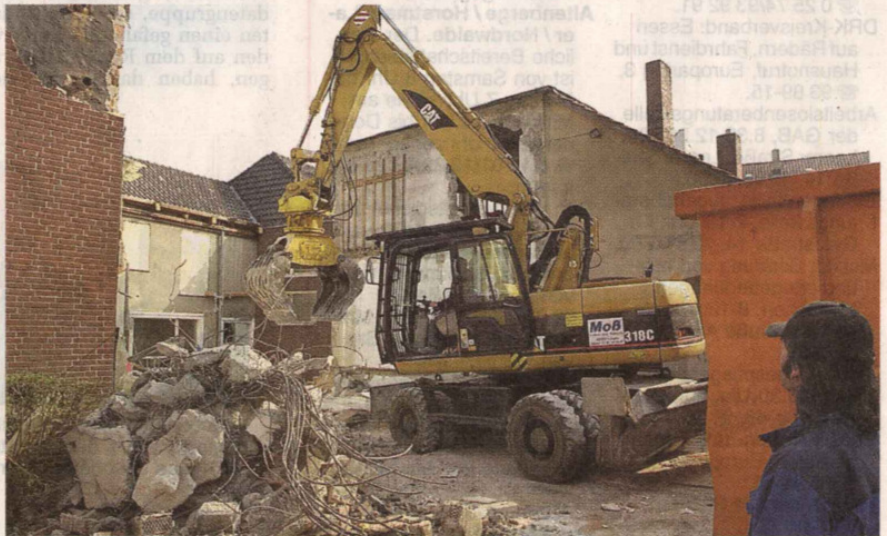
Der Abrissbagger ist bereits dabei, die alte Werkstatt abzutragen. Dort sollen kleine Gartenparzellen für die zukünftigen Bewohner entstehen.
