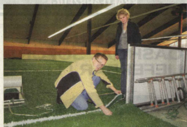
Auch die Markierungen wurden auf den drei Courts bereits aufgebracht. Fotos (4): Kratzke
